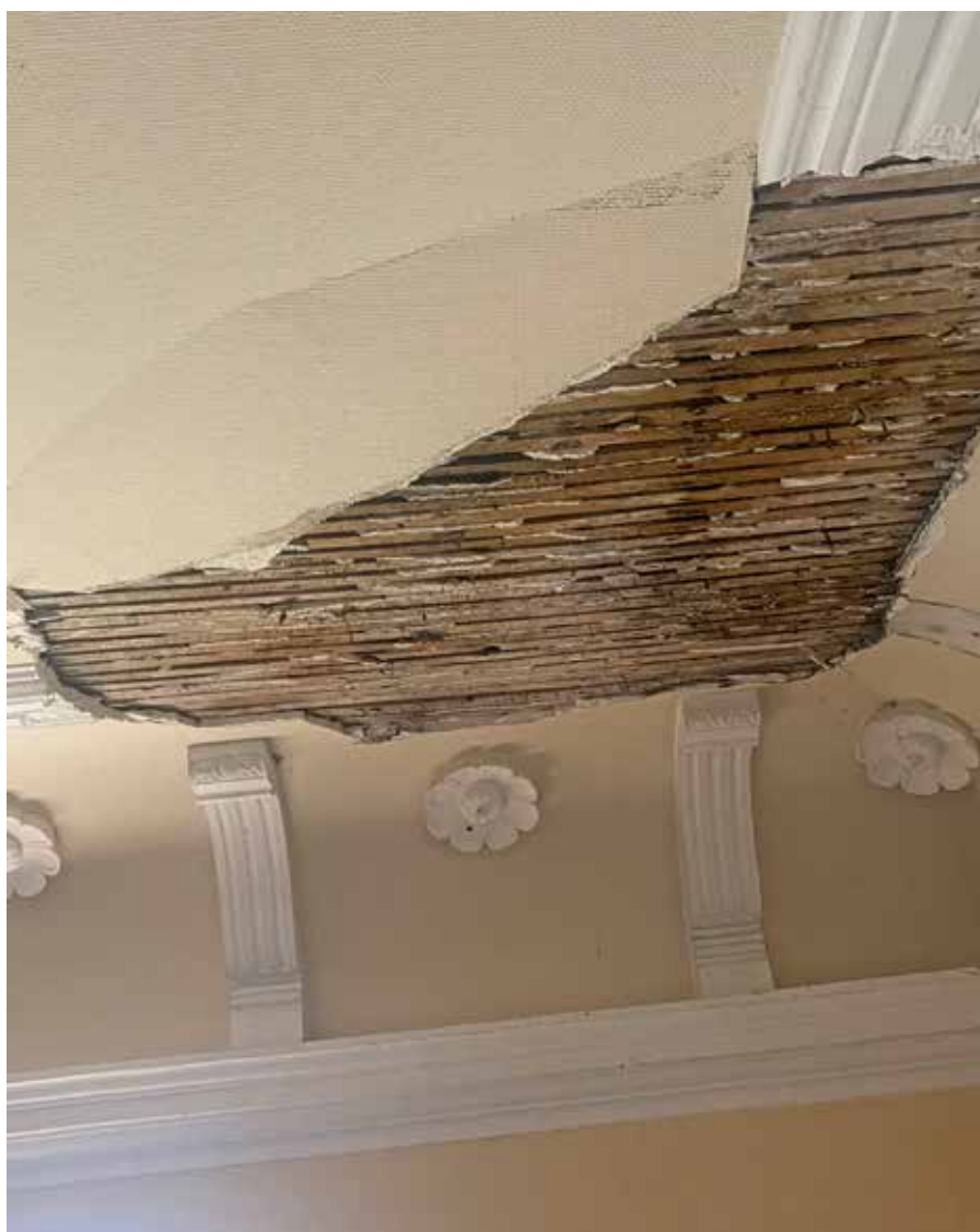
Le lattis mis à nu suite à l'effondrement d'une partie du plafond de la tribune Sud
